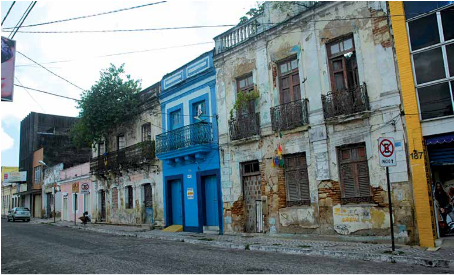
Já foram identificados 86 prédios em situação de risco grave, alguns deles apenas com paredes dianteiras com plantações
