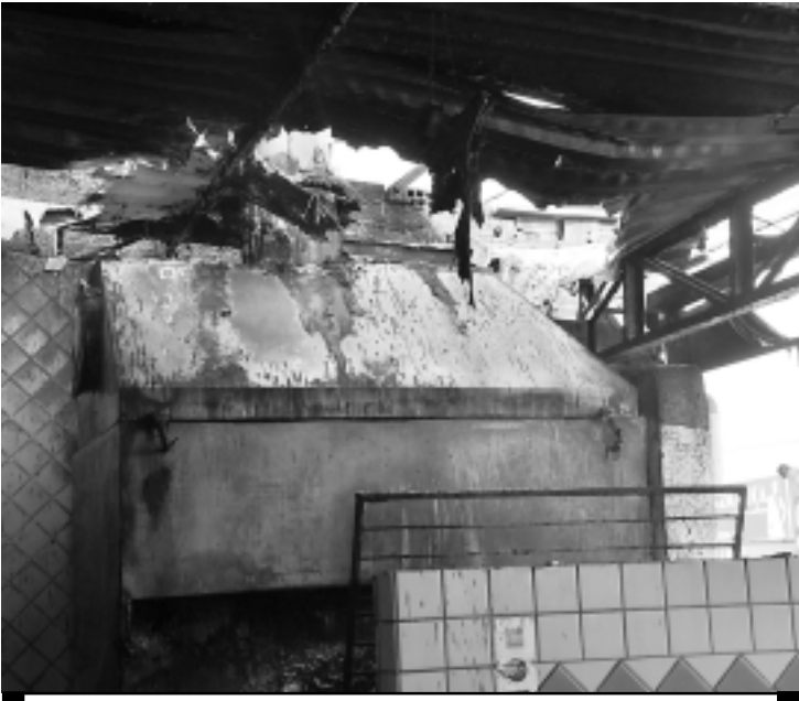
Parte do estabelecimento comercial foi destruída pelo fogo
