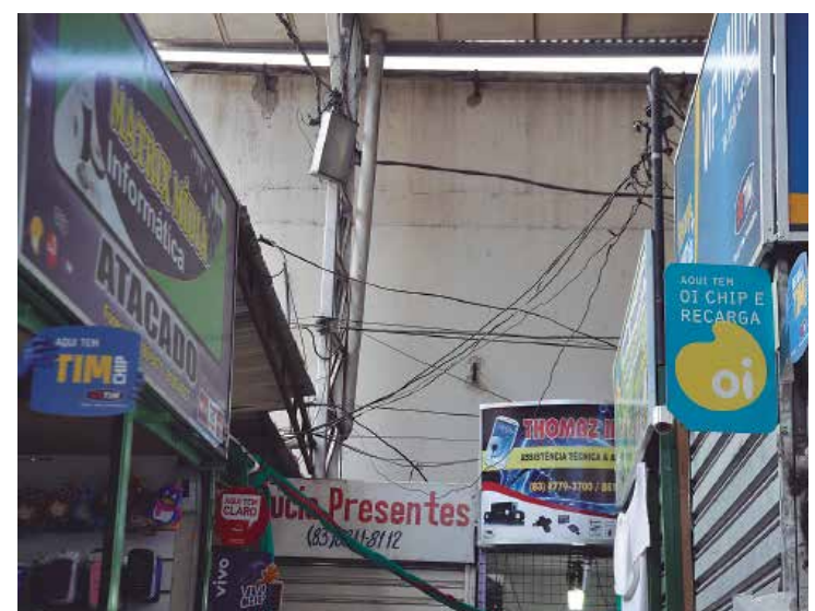
Toda a parte elétrica do centro comercial se encontra deficitária
