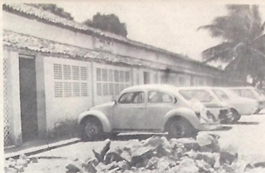
O prédio onde funciona o Hospital Padre Zé está necessitando de reformas
