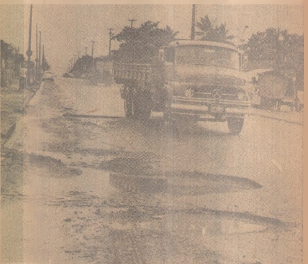
Os buracos estão atingindo parte da pista
