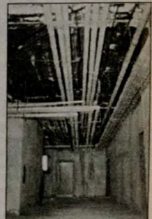
Obra inacabada: falta verba
