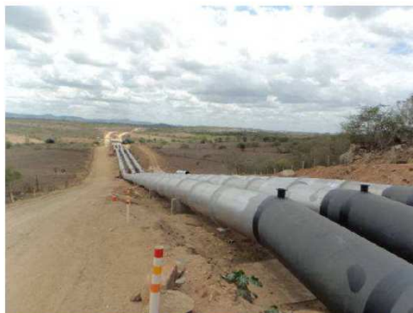
Sifão Surrão – Início da Tubulação Metálica – DN = 1900mm (três linhas de Tubulação) – Estaca – E-141
